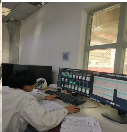
生产集中控制室
